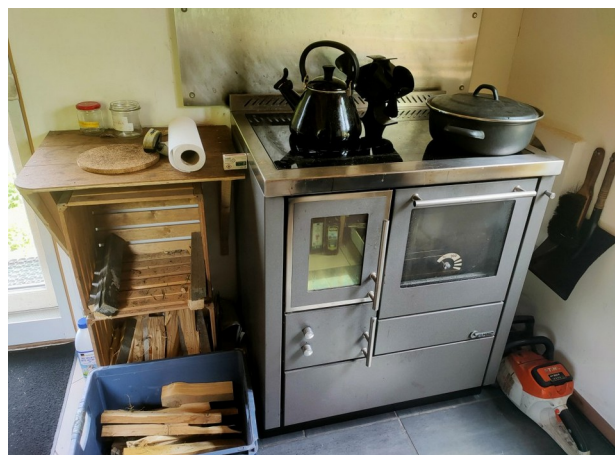
Kochherd (Kochen, Backen, Warmwasser, Heizen)
