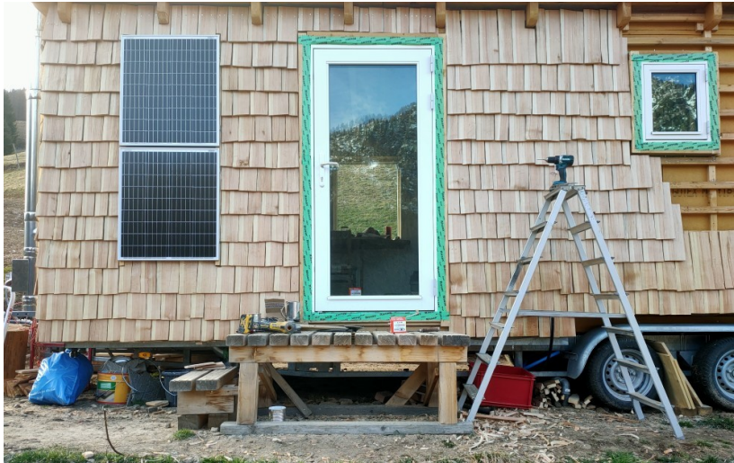
Solarmodule in der Außenwand integriert
